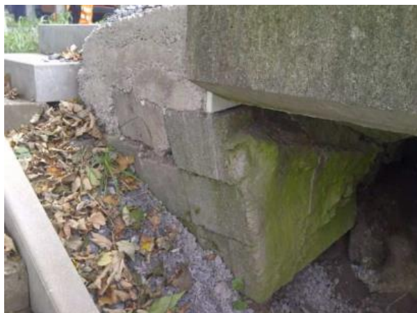
Schäden an Brückendenen Bildquelle: Hessen Mobil
