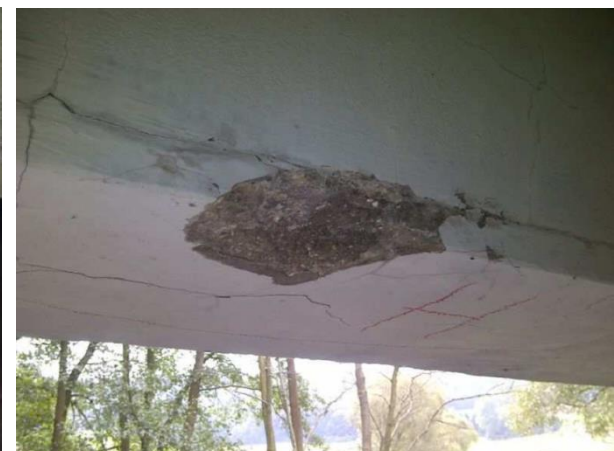
Abplatzungen an den tragenden Elementen Bildquelle: Hessen Mobil
