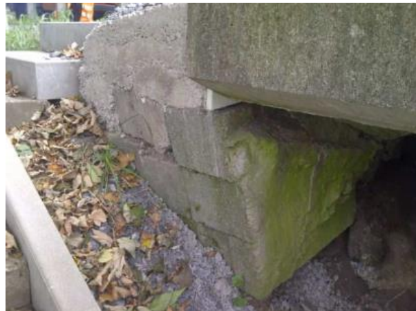
Schäden an Brückendenen Bildquelle: Hessen Mobil
